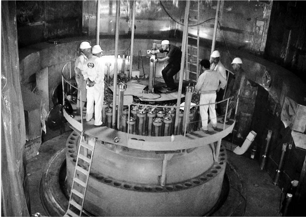
Foto de 2004 de trabajadores rusos ayudando a la construcción de la central nuclear de Bushehr, al sur de Irán.
