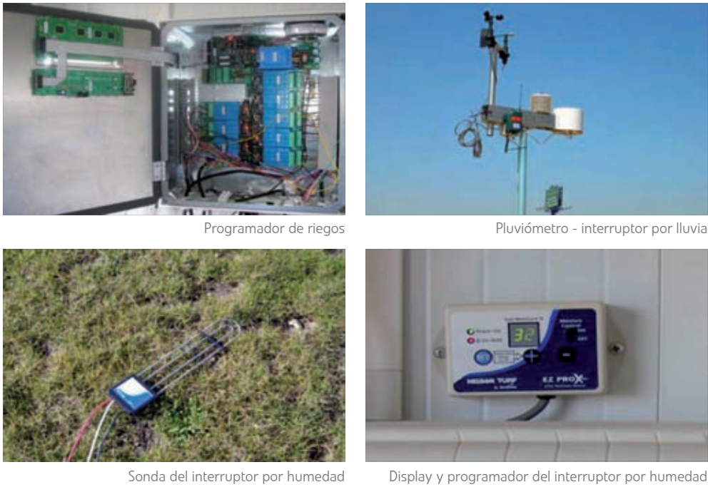
Figura 6. Programador, pluviómetro e interruptor por humedad
