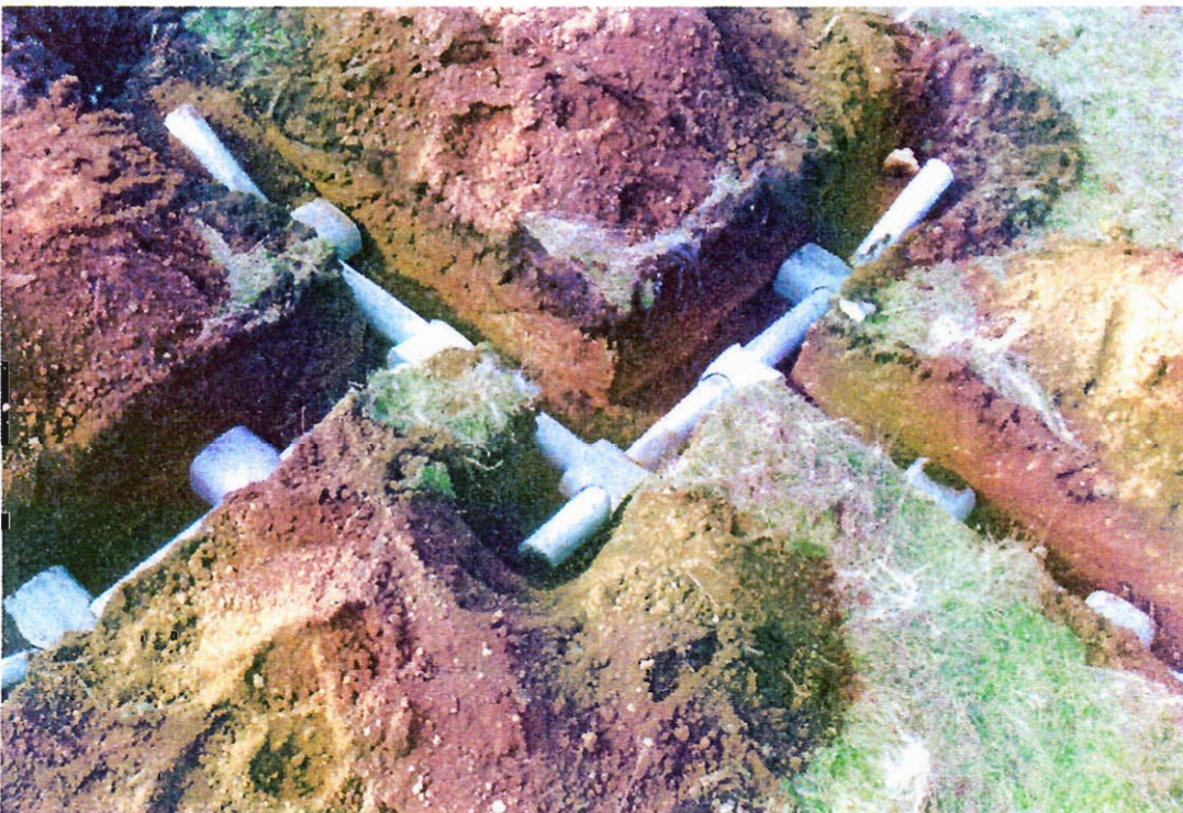
Foto 16: Vivares de tubos. Detalle.
