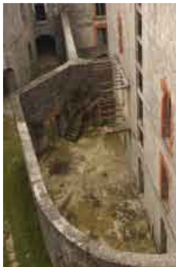
Dos de los muros derribados.
